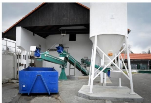
hygienizace kalu vápnem - HKV, ČOV Lednice
