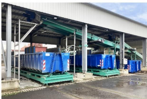
kolejová kontejnerová doprava - KD, ČOV Modřice
