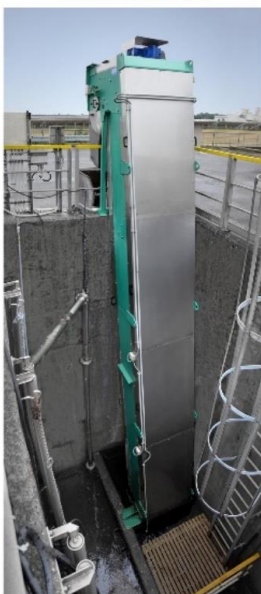
samočistící česle - SČČ, ČOV Prostějov
